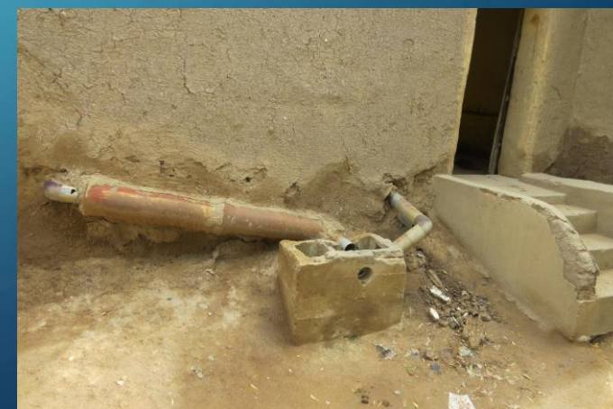
Photo N° 20: Djenné: vue sur un système d'évacuation –
