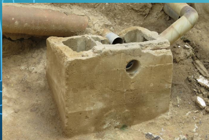
Photo N° 18: Djenné: vue sur un système d'évacuation –
