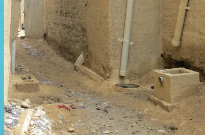
Photo N° 19: Djenné: vue sur un système d'évacuation –
