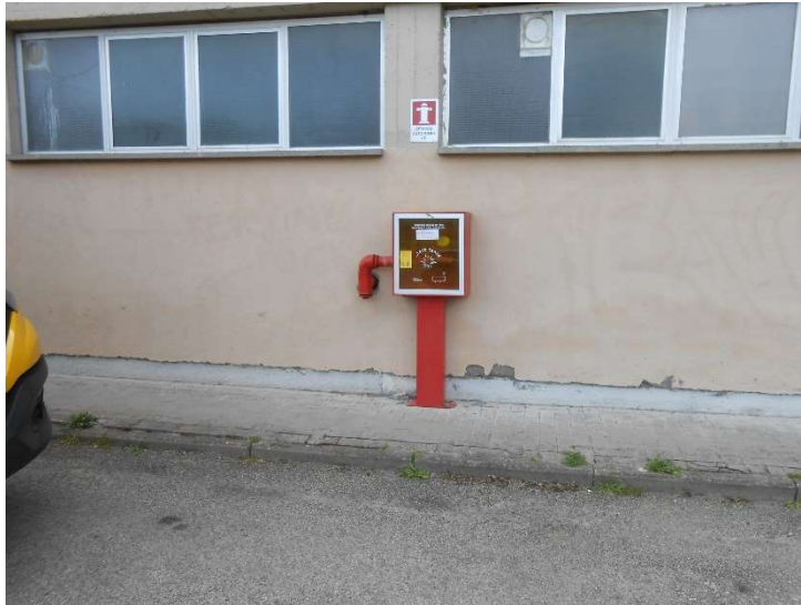
Immagine n. 15 – Dispositivo di presa localizzato in comune di Porano, area urbana, nei pressi della palestra comunale. Attacco di presa UNI 45.
