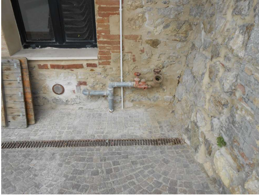
Immagine n. 3 – Dispositivo di presa localizzato in loc. Allerona, centro storico, nei pressi della Sala Aurora. Attacco di presa UNI 70.
