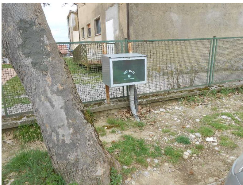
Immagine n. 6 – Dispositivo di presa localizzato in comune di Ficulle, area urbana, nei pressi della Scuola Media. Attacco di presa UNI 70.
