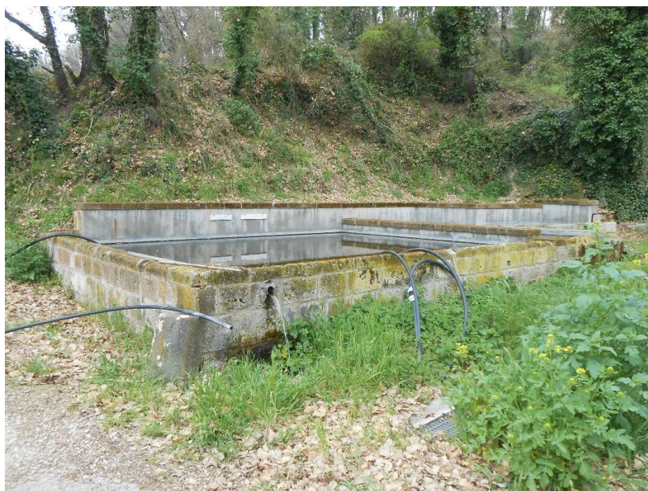
Immagine n. 4 – Loc. Bardano (Comune di Orvieto). Accessibile con Fuoristrada– Stimato in circa 20 mc complessivi lo stoccaggio utile delle vasche.
