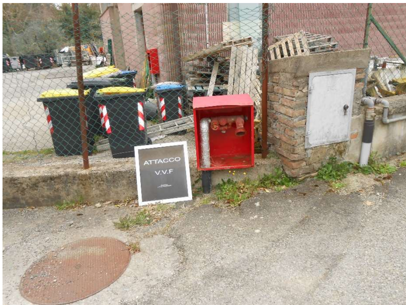
Immagine n. 5 – Dispositivo di presa localizzato in comune di Ficulle, area urbana, nei pressi della Caserma dei Carabinieri. Attacco di presa UNI 70.
