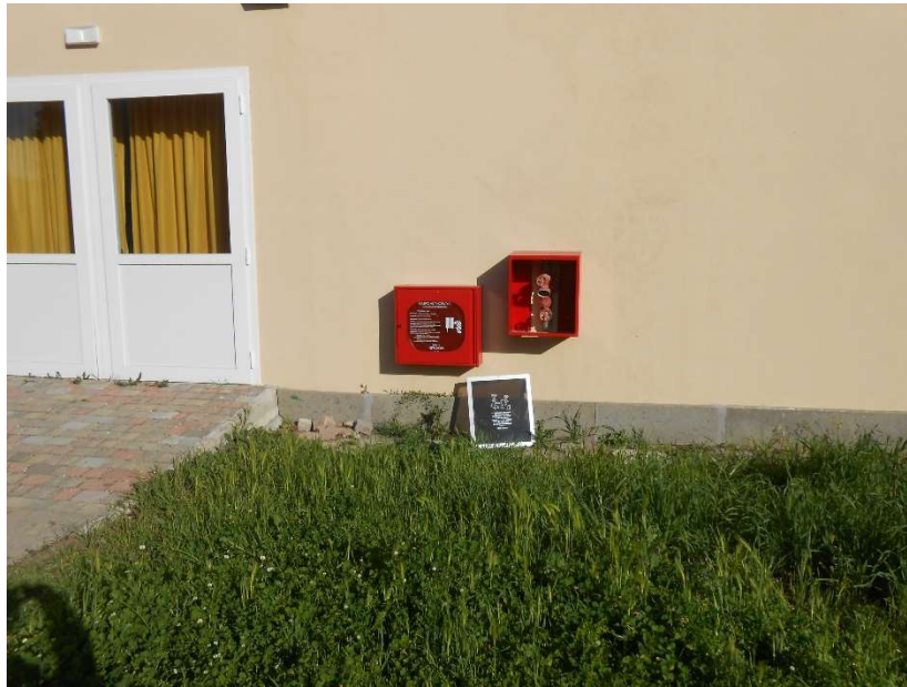
Immagine n. 1 – Dispositivo di presa localizzato in loc. Allerona Scalo, area urbana, nei pressi dell'area artigianale. Attacco di presa UNI 70.
